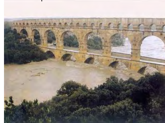
◆ Crue de 2002 au Pont du Gard
