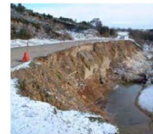
◆ Glissement / érosion de berge - crédit photo DREAL Occitanie
